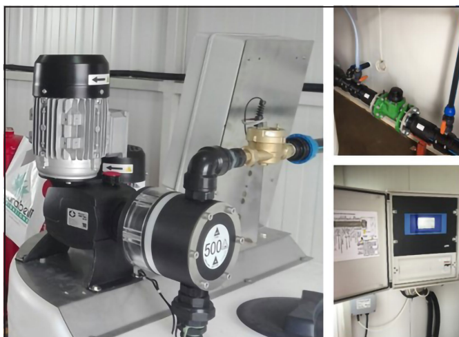
Figura 6.26 - Sistema di immissione del fertilizzante con pompa dosatrice e unità di controllo.
