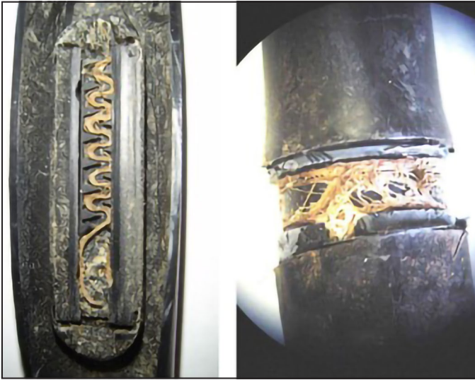
Figura 6.22 - Erogatori invasi da radici: le prestazioni risultano compromesse.
