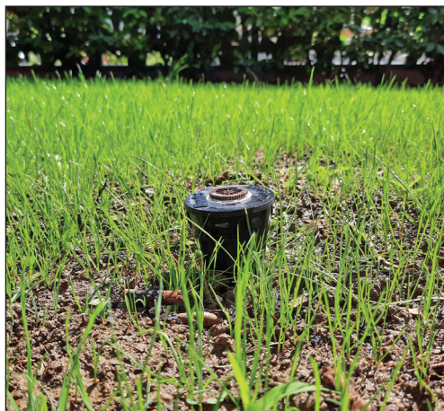
Figura 6.11 – Irrigatore installato in modo errato perché non sufficientemente interrato. Il non preciso livello dell'irrigatore con il piano del terreno lo rende soggetto ad essere danneggiato con il tosaerba.
